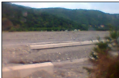
Рис. 1. Фрагмент разрушенной берегозащитной плотины Гейчай
