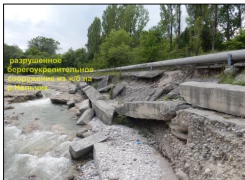
Рис. 3. Разрушенное берегоукрепительное сооружение из ж/б на р. Нальчик
