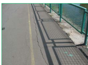
Рис. 4.20. Проявление оползневых процессов на набережной пос. ЛМС
