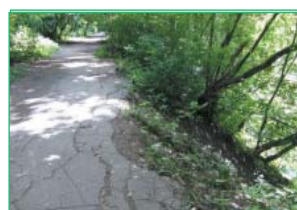
Рис. 4.8. Стенка срыва оползня на участке Хорошево-2
