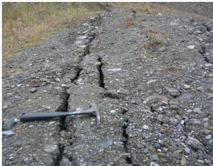
Рис. 5.6. Около отрыва оползня наблюдались трещины на поверхности (фото автора 2016г.)
