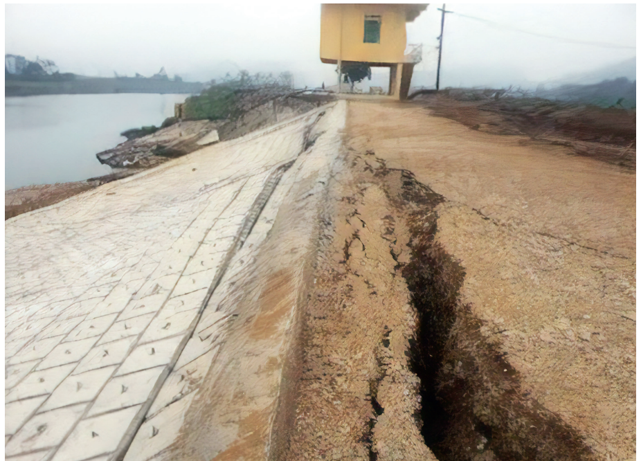
Рис. 4. Трещины в теле дамбы (фото Т.Х. Динь)
