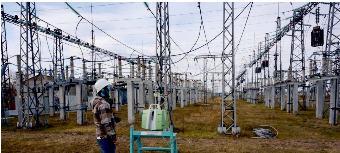
Рис. 1. Лазерное сканирование электрической подстанции
