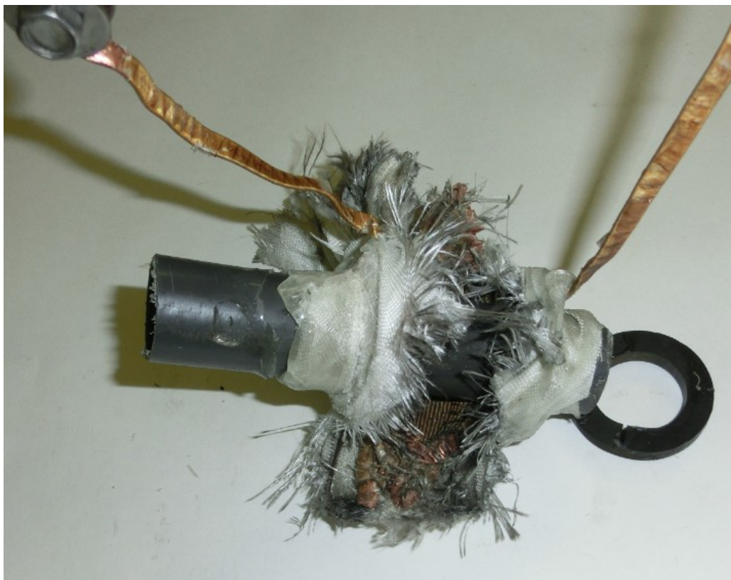
Рисунок 15. Разрушенный второй соленоид
