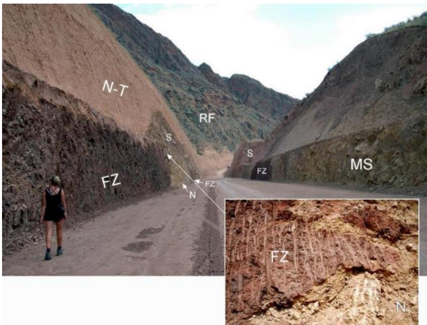
Внизу – неперемешанные обломки пород в прорези строящейся дороги. Ms - обломки метаморфизованных осадочных пород палеозоя; FZ - тектонически нарушенные породы зоны разлома; N – разрушенные неогеновые конгломераты; S – материал осыпи, перемещенный из подножия левого борта долины Кокомерена; N-T – отложения осыпей с правобережного борта долины, сложенного неогеновыми конгломератами; RF – обвалившиеся глыбы неогеновых конгломератов
