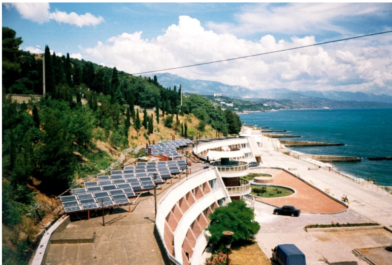
Рисунок 1. Солнечная котельная, г. Алушта, санаторий «Рабочий уголок», 200 м 2 . Работает с 2002 г., 20 куб.м. горячей воды в день
